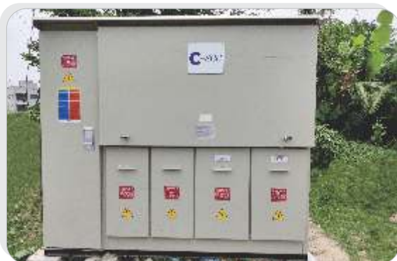
11kV Motorised RMU
